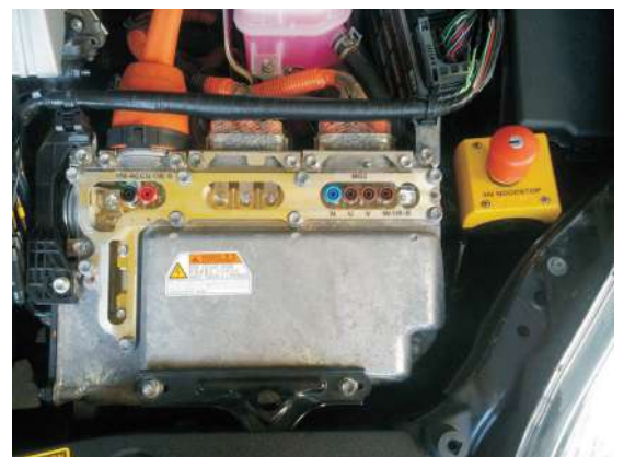
Messpunkt Inverter HV-Akkus 10:1 und Wechselspannung
